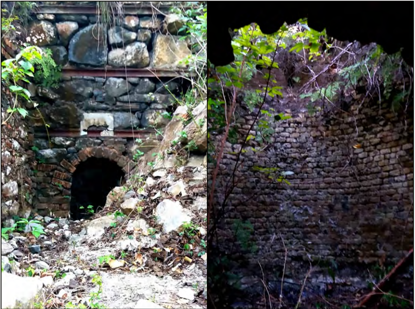
Horno de cal de Sardá en El Abra. Fotos Rafael Calvo González.
