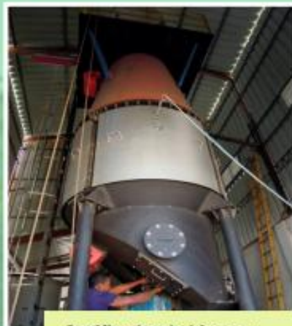
Gasificador de biomasa para secar arroz y generar electricidad así como para procesar residuos leñosos
