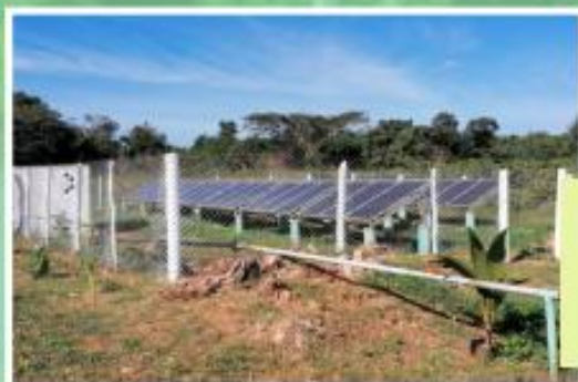
Uso de sistemas fotovoltaicos para alumbrado, bombeo de agua y sistemas de riego
