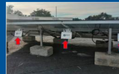
Interconexión de los módulos solares fotovoltaicos con los microinversores.
