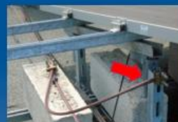
Aterramiento de la estructura de los módulos fotovoltaicos
