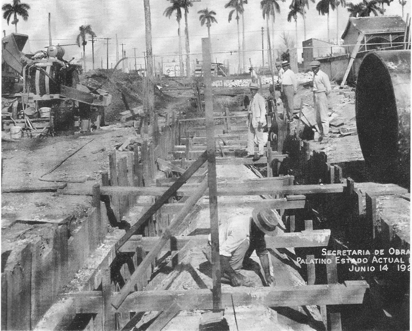
CONDUCTO DE 60 PULG. DE DIAMETRO INSTALADO PARA LA ALIMENTACION DE LAS BOMBAS DE PALATINO. EL CONDUCTO EN CONSTRUCCION.
