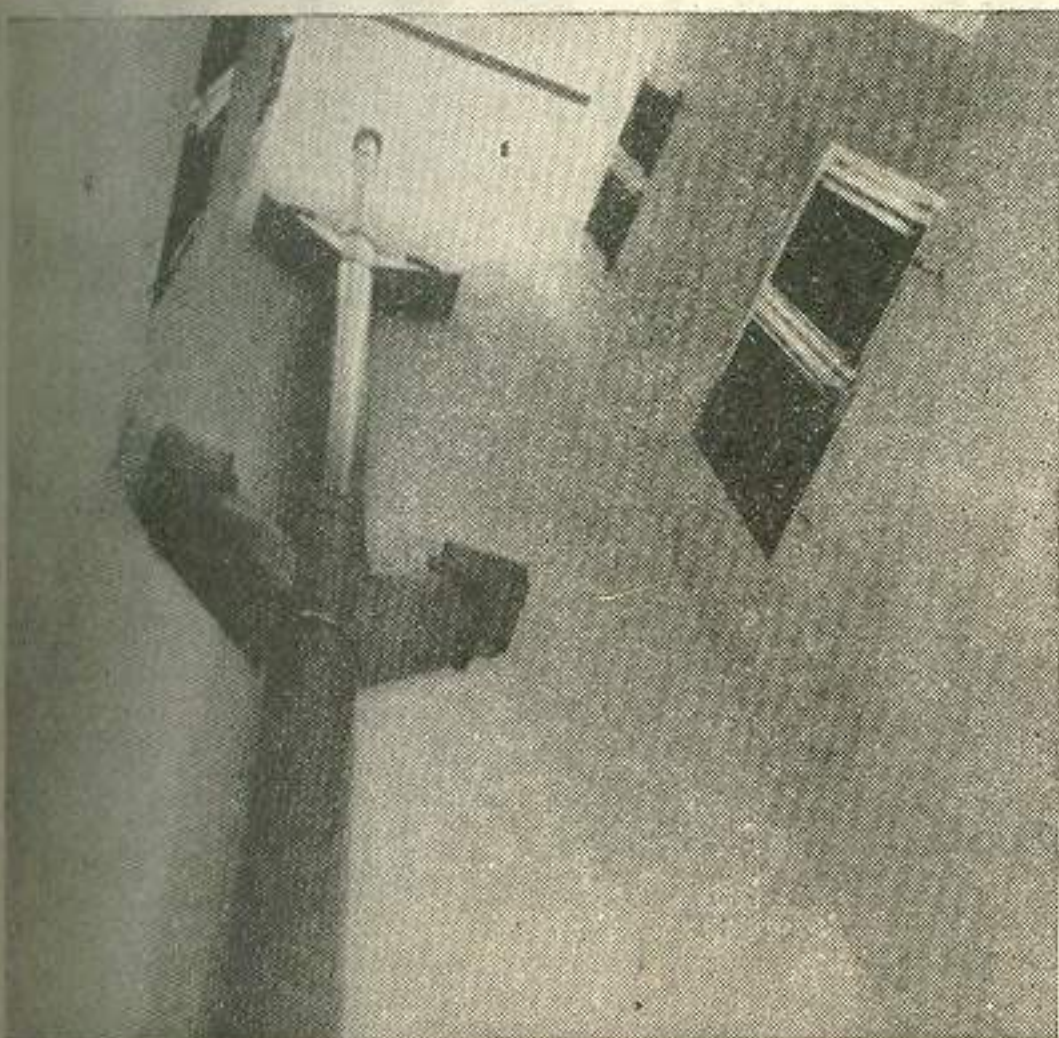
Detalle de los receptores para basura, automáticos, instalados por la importante firma industrial Amaro Blanco.
