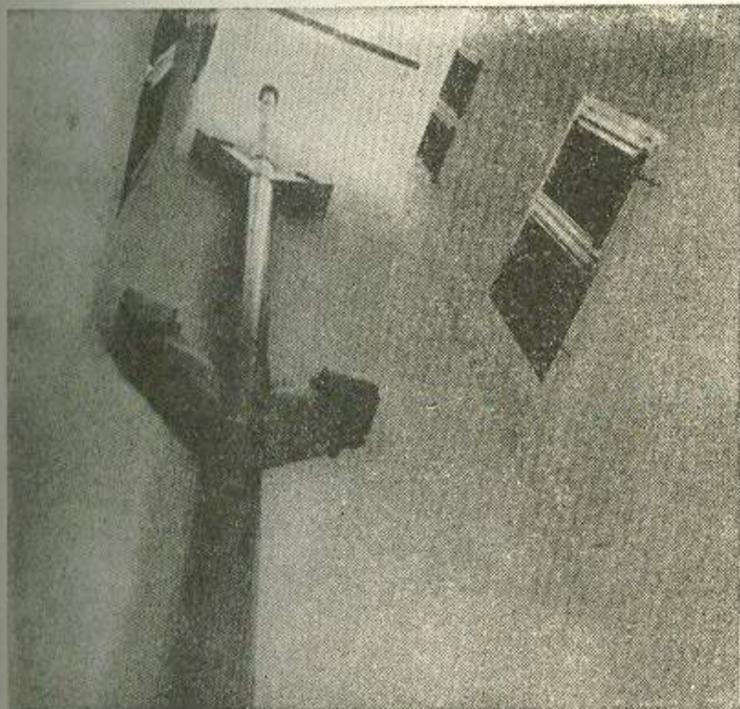
Detalle de los receptores para basura, automáticos, instalados por la importante firma industrial Amaro Blanco.
