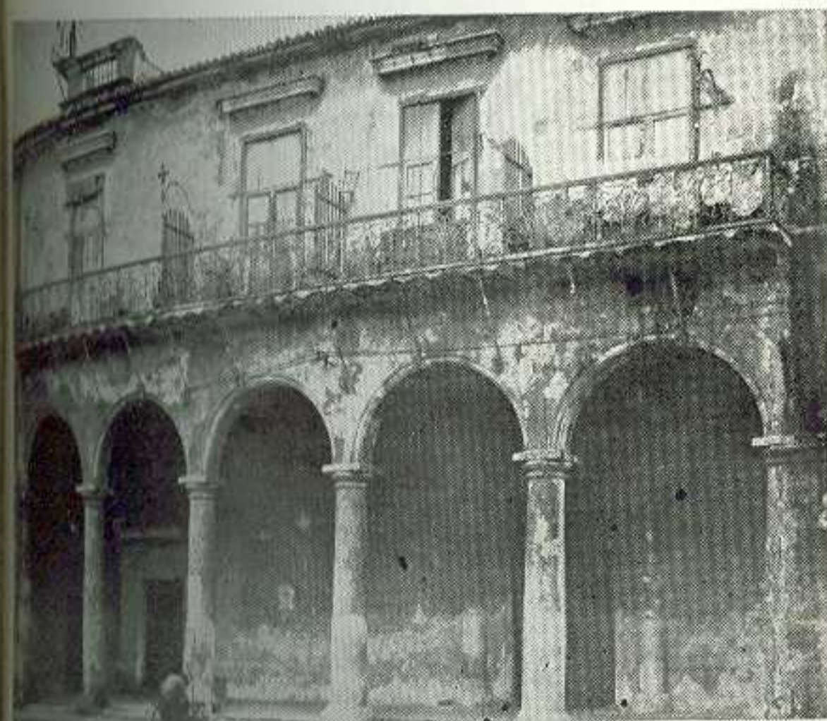
El Palacio del Marqués de Arcos antes de ser restaurado, mostrando, en la suciedad de sus paredes, el estado de deterioro en que se encontraba.
