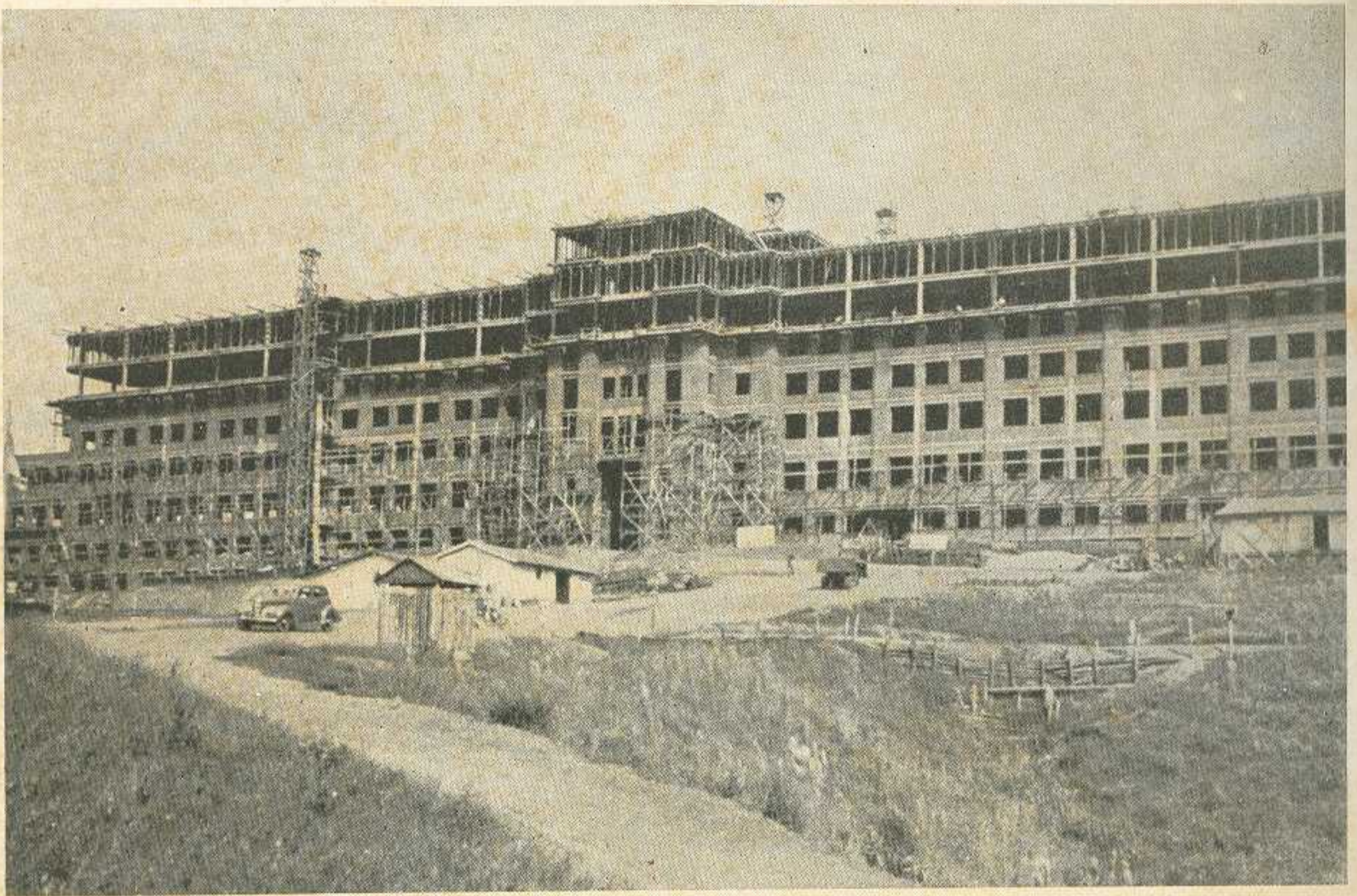
Un detalle de las obras, antes de quedar terminados los muros de ladrillos de las cuatro fachadas.
