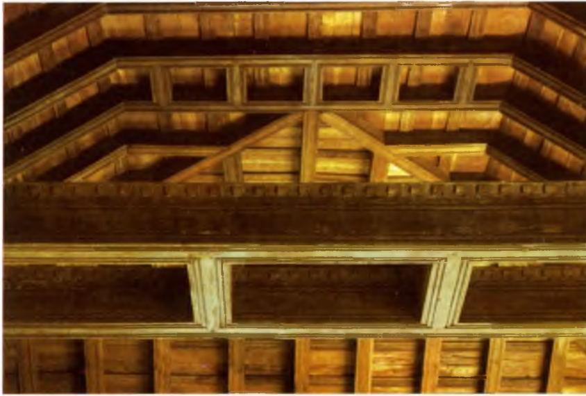
La secuencia de nudillos y su entablado se conoce como harnuelo o almizate. La cubierta toma así forma de artesa y propicia decoraciones con lacerías o figuras geométricas.
