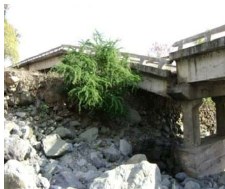
Foto: Puentes de carreteras afectados por terremotos.
