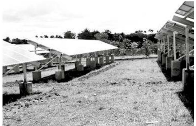
Fig.1. Instalación solar fotovoltaica.
