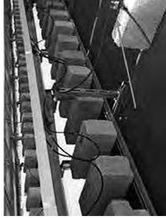
Fig. 7. Aterramiento de la estructura de los módulos fotovoltaicos.
