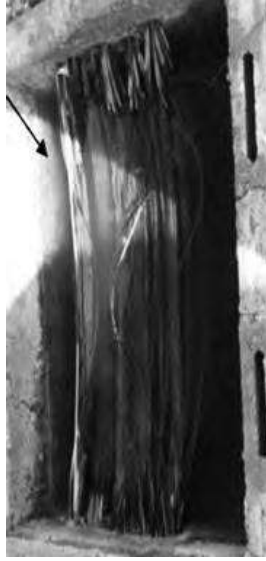
Fig. 2. Aguas en los registros y mala organización del cableado fotovoltaico.
