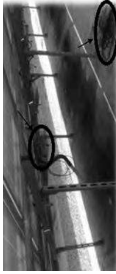
Fig. 3. Mala organización del cableado fotovoltaico y el área sucia.
