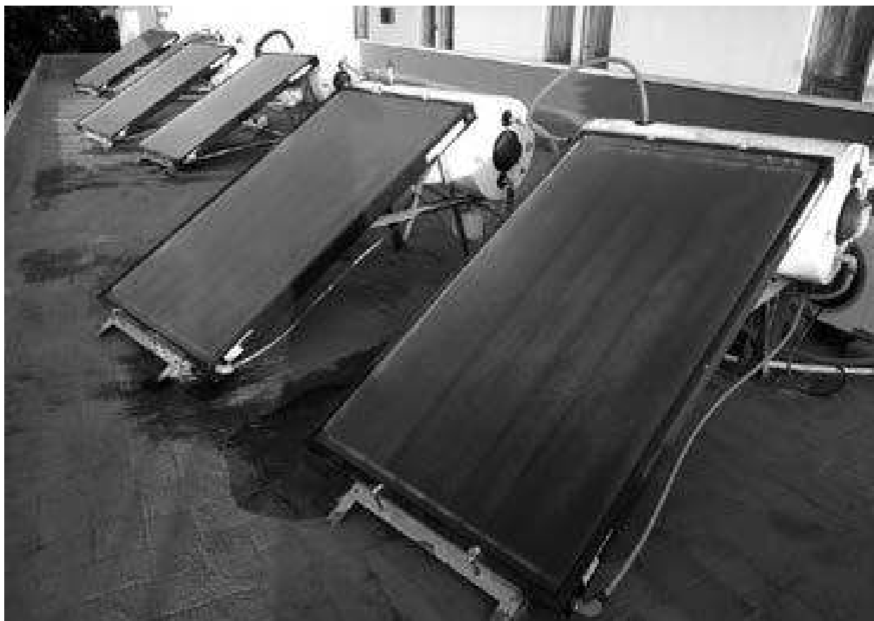
Los calentadores solares ofrecen soluciones locales para el calentamiento del agua.
