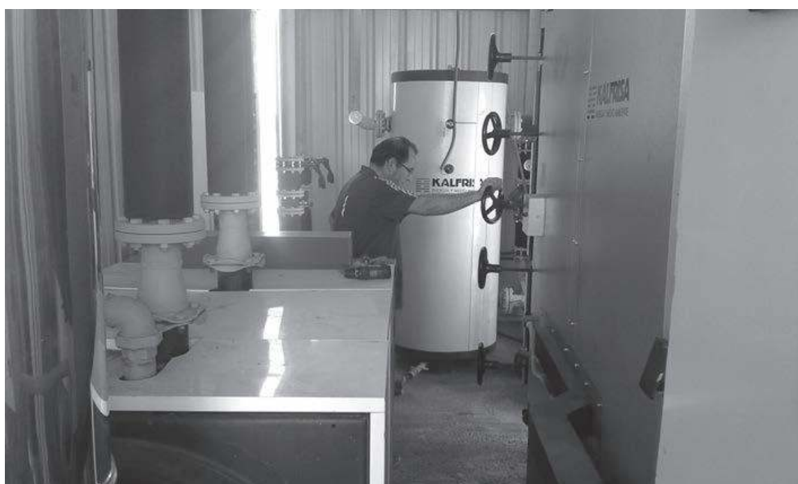
Fig. 3. Sala de caldera.
