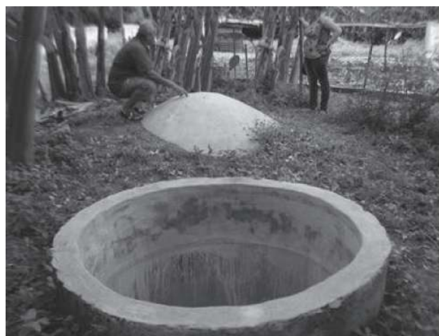
Fig. 3. Imágenes del biodigestor del productor Deibis Pérez Bermúdez.
