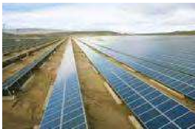
Fig. 1. SFV similares pero con anclajes al suelo distintos.
