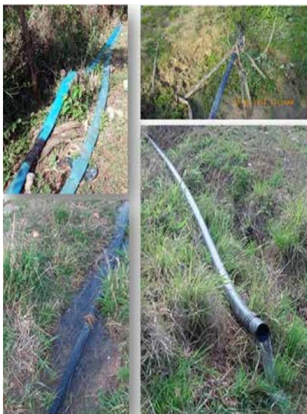
Fig. 3. Acometidas ilegales improcedentes.
