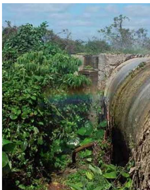
Fig. 5. Salidero en la Conectora.
