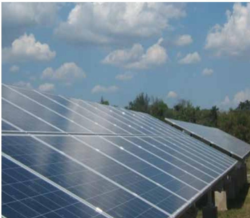
Fig. 6. Mesas con paneles fotovoltaicos. Fuente 6 [Frómata Martínez, 2018].
