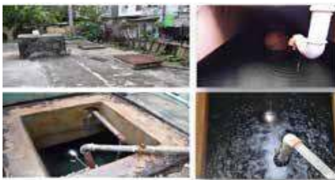
Fig. 1. Fotos de flotantes Instalados.
