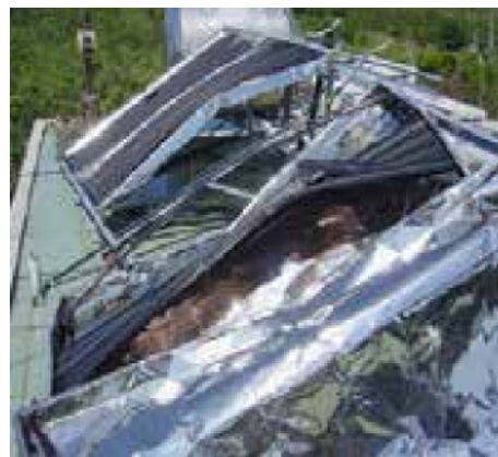
b) Destrucción de calentador solar sobre cubierta.
