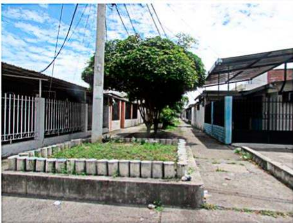
Fig. 11. Adición de espacio techado que afecta la habitabilidad interior de la vivienda en Portoviejo.
