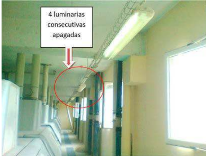
Fig. 3. Sistema de iluminación actual mostrando deficiencias por lámparas falladas. (Fotografía cortesía de los autores).
