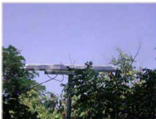
Fig. 2. Panel fotovoltaico sombreado. Falla usual detectada en la visita de campo.
