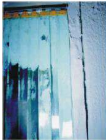
Fig. 3. Puertas y paredes de una cámara de refrigeración.
