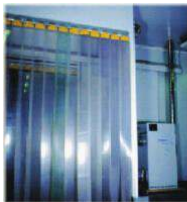
Fig. 4. Cámara de congelados con un deshumidificador MUNTERS
