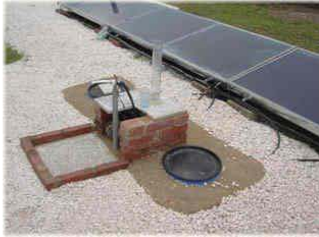
Fig. 2. Instalación RSD F8-250.
