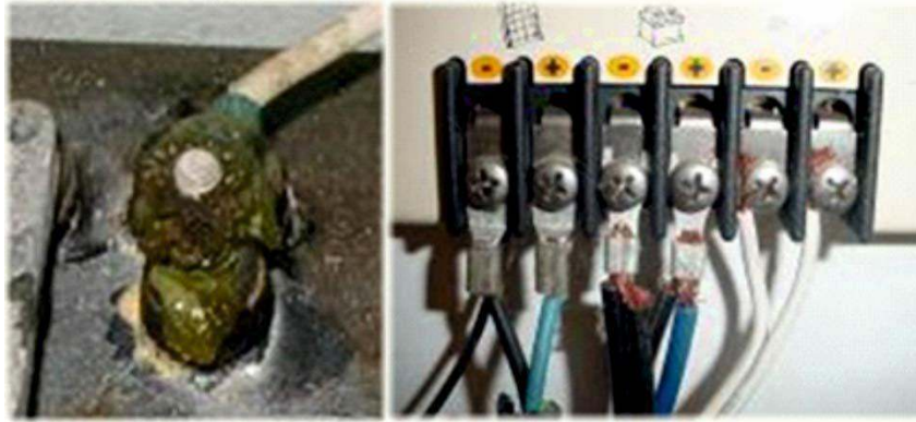
Fig. 3. Conexión eléctrica y efectos de corrosión
