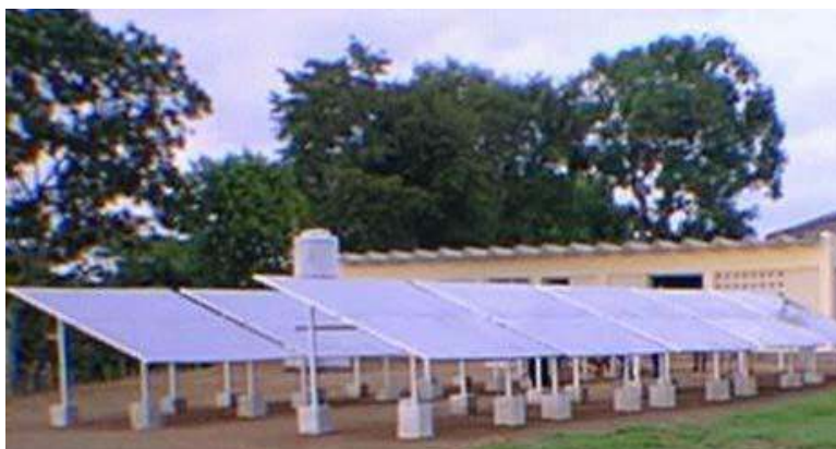
Fig. 5. Sistema fotovoltaico Santa María del Loreto, del municipio de Songo-La Maya.
