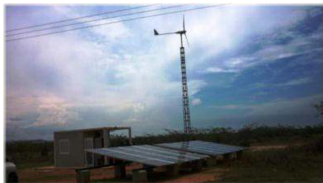
Fig. 4. Sistema híbrido eólico-fotovoltaico-diésel, una de las tecnologías que puede ser evaluada con el apoyo brindado por los SIG
