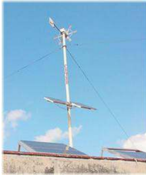
Fig. 1. Sistema híbrido eólico-fotovoltaico con fines docentes, instalado en el Centro de Estudio de Tecnologías Energéticas Renovables (CETER).
