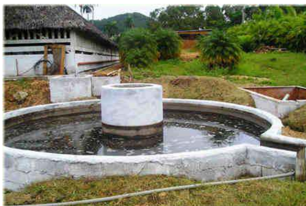
Fig. 1. Una de las decenas de plantas de biogás instaladas en la provincia de Matanzas.
