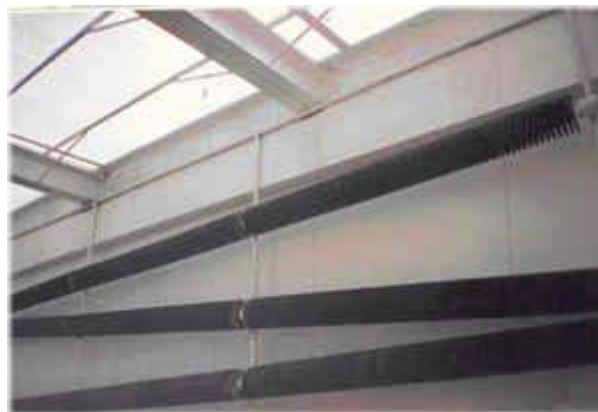
Fig. 5. Intercambiadores de calor ubicados en las paredes interiores del veranero.
