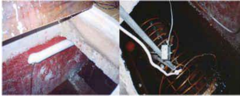
Fig. 6. Tanque de agua fría.
