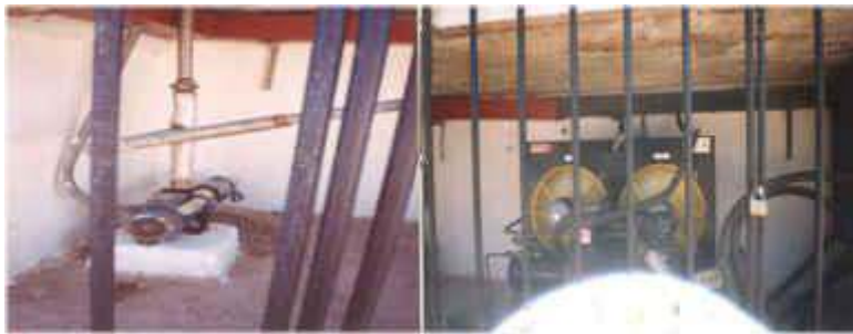
Fig. 7. Bomba de agua fría y unidad condensadora.
