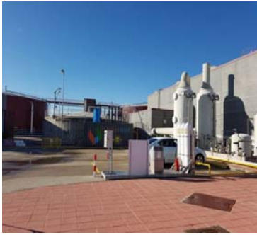
Instalaciones Depuradora Guadalajara/Foto SER Guadalajara
