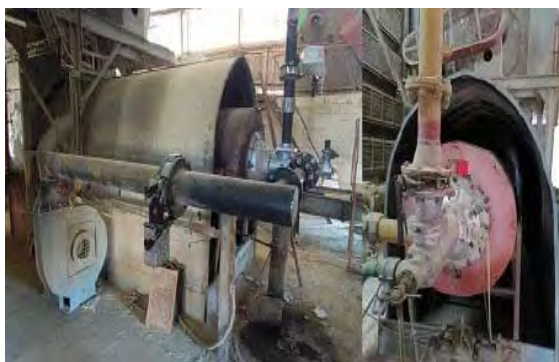
Figura 2. Quemador dual (gas/diesel) del secadero de la UEB de Amarillas.
