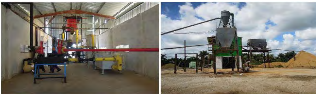
Figura 1. Área interna y externa del gasificador de la UEB de Amarillas.
