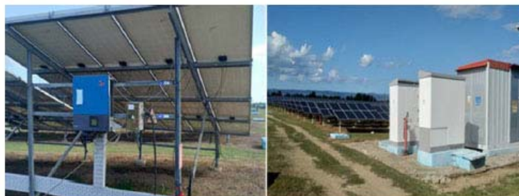
Figura 2 Imágenes de las tecnologías de inversores instalados en los parques de la empresa.
