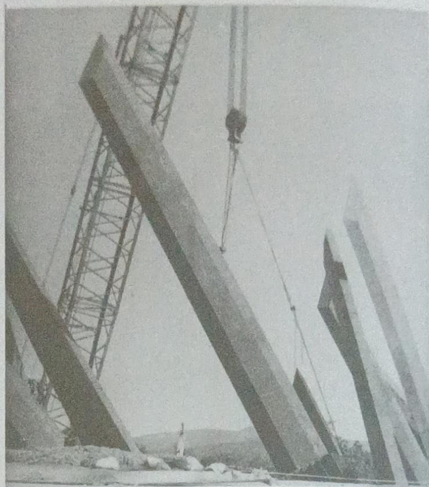
Construcción de la Plaza de la Revolución Mayor General Antonio Maceo Grajales. Santiago de Cuba
