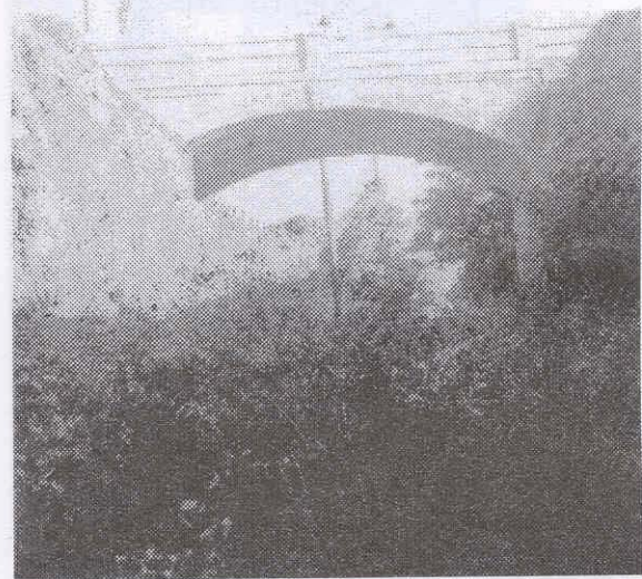
Trinchera-viaducto del ferrocarril de Fésser y puente de la Calzada de Guanabacoa.
