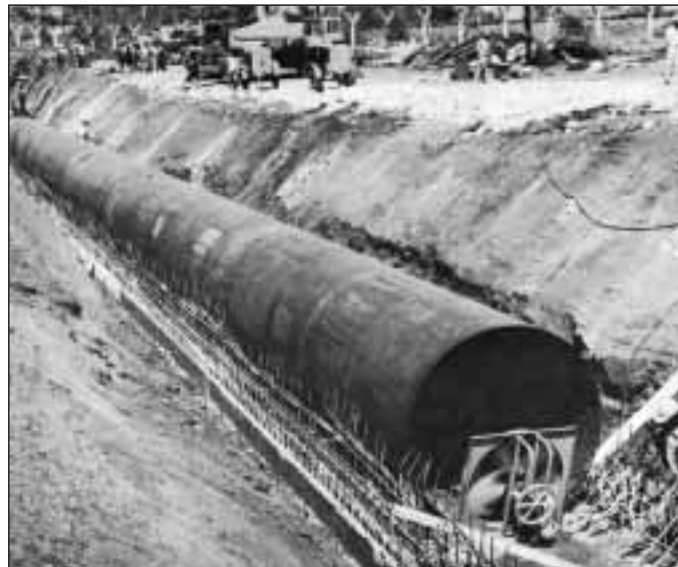
Conductora de 66" de diámetro
