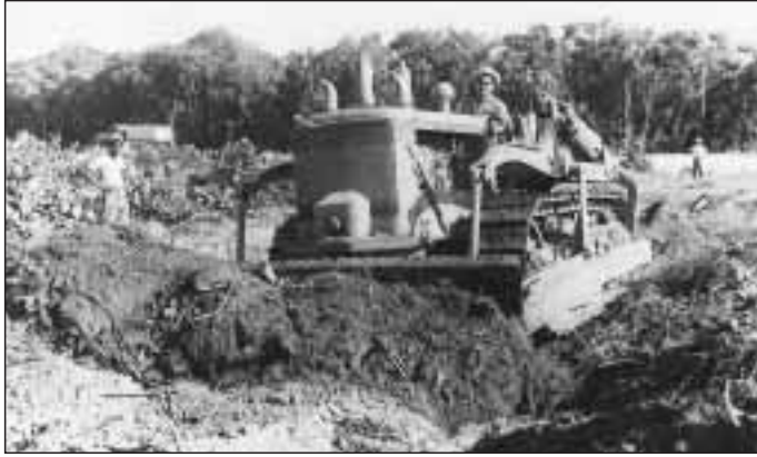
Trabajos en la Vía Blanca cerca del puente de Bacunayagua, el operador del bulldózer es José Ramón Lima Joya, que llegaría a ser uno de los constructores destacados del siglo
