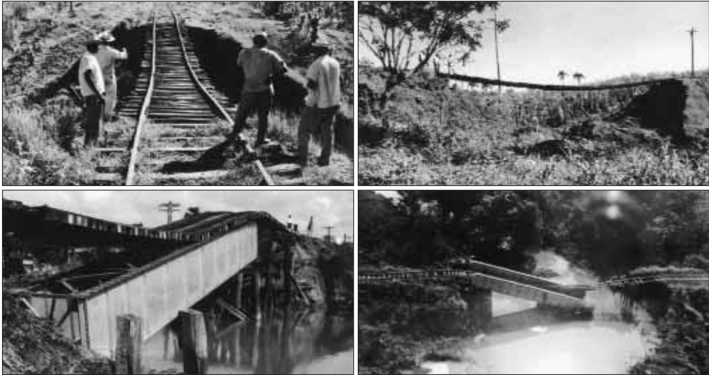
Imágenes que muestran varios de los puentes ferroviarios afectados
