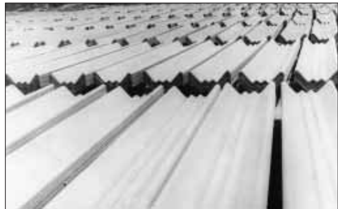
Patio con canalones de asbesto cemento
