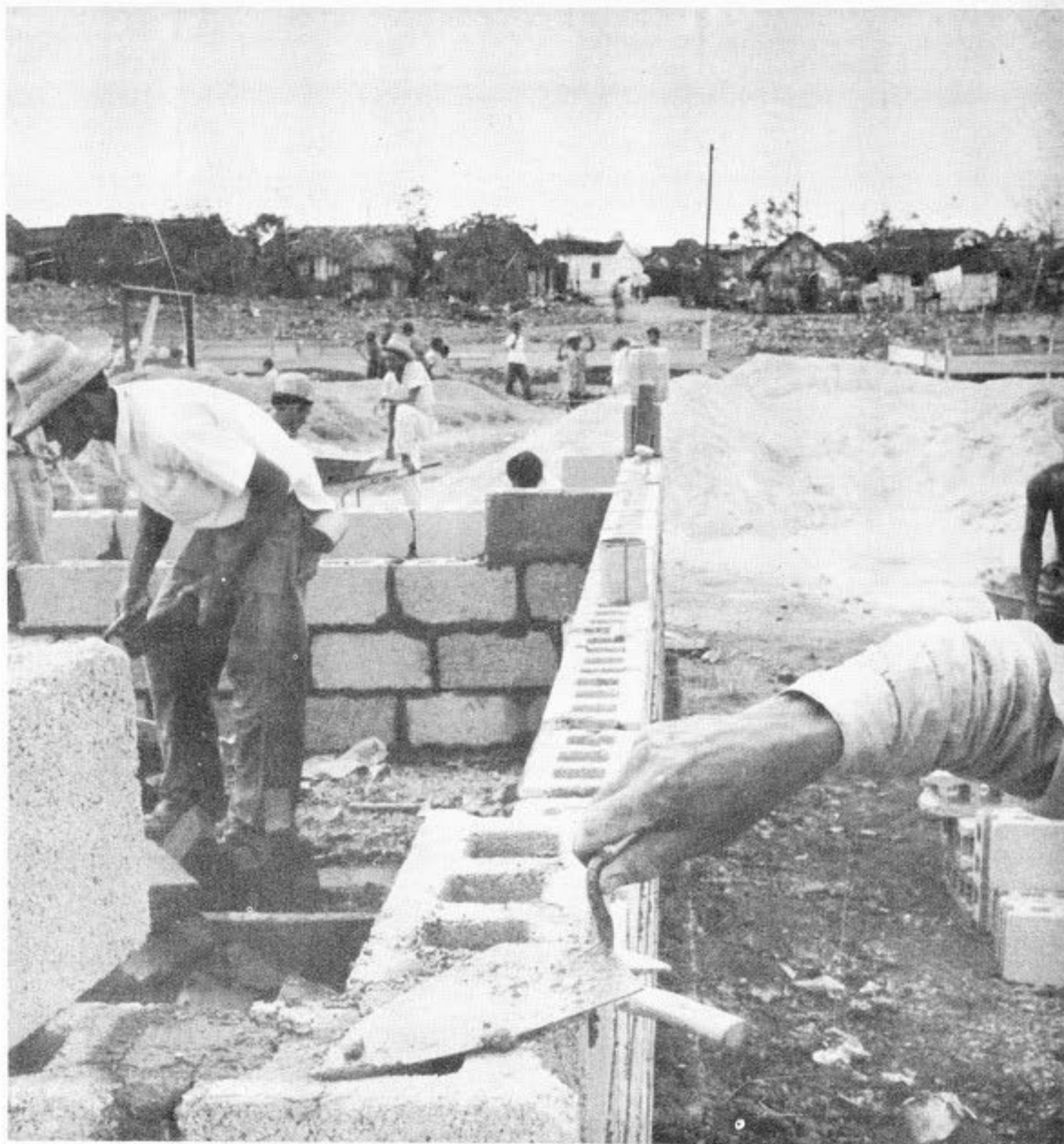
Los bloques comienzan a apilarse. Las paredes se levantan. Las casas surgen y van desplazando a los bohíos insalubres, de techo de guano y piso de tierra, donde han malvivido hasta el presente los moradores de "La Chirusa".
