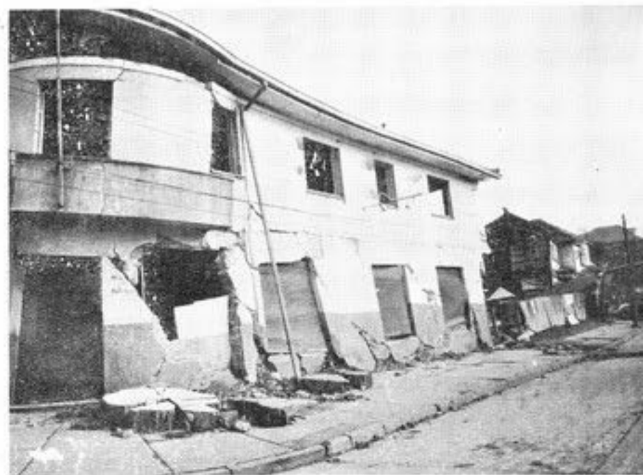
Otras viviendas quedaron medio destruídas.
