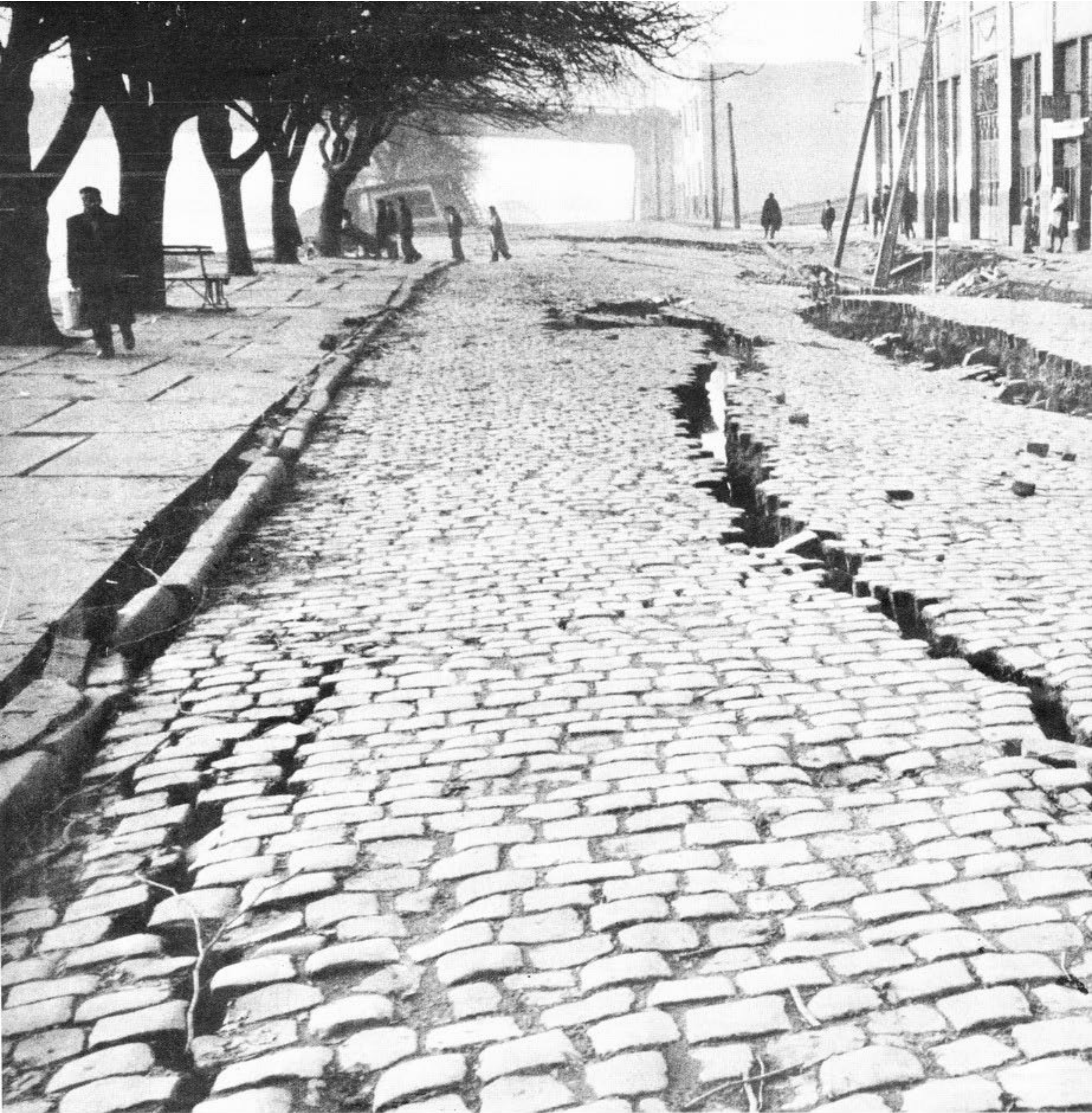
Una calle de Ciudad Valdivia: los sucesivos terremotos hicieron saltar el pavimento, las aguas penetraron por las grietas y socavaron los cimientos de las casas.
