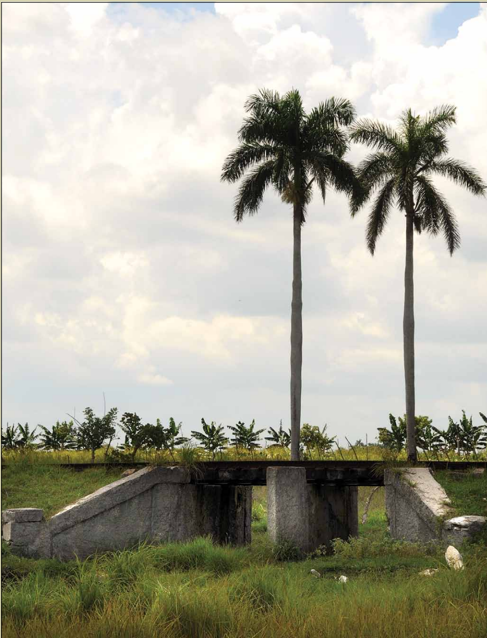
ILUST. 191 PUENTE DE FERROCARRIL DE LA LÍNEA DE LA SABANILLA, EN LA CERCANÍA DEL INGENIO ÁCANA, 1848.
