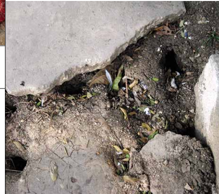
FIGURA 35. Daños de rata parda en acera peatonal.
